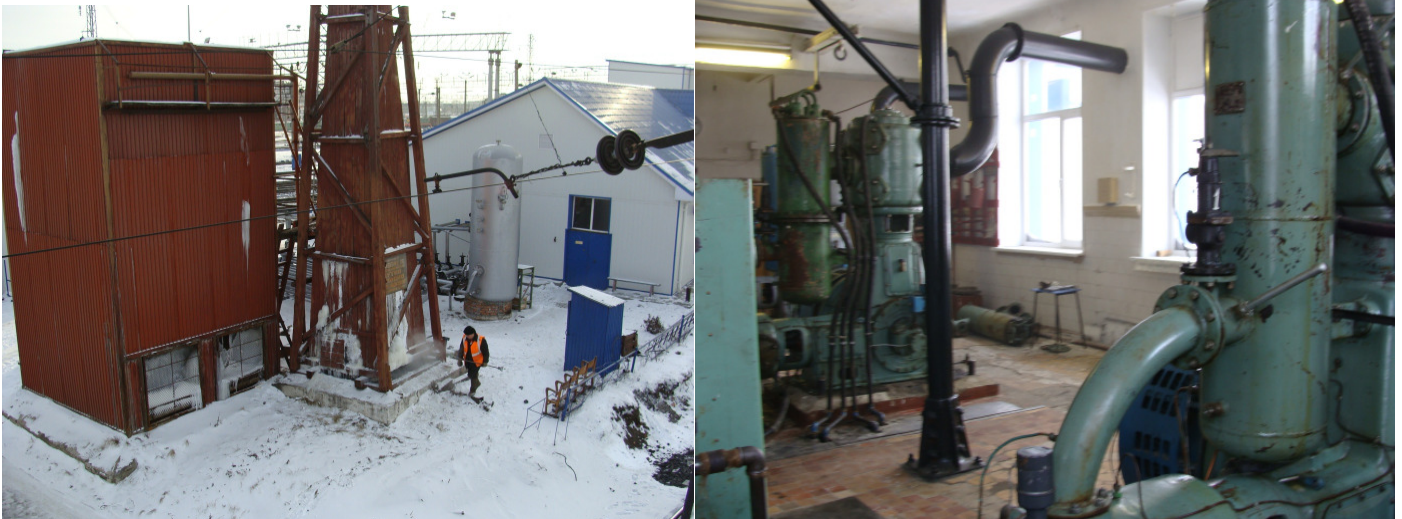
Рисунок 5. Компрессорная станция – нечетная система Челябинск-Главный
